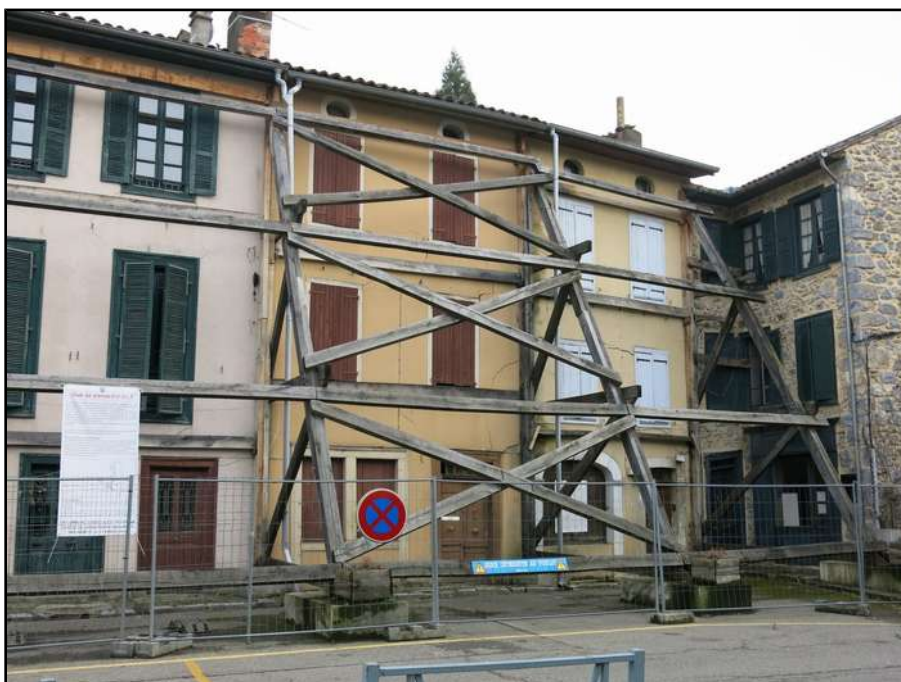
Figure IV.5: Les bâtiments affectés par des tassements au centre d'Aspet (Place de la République).
